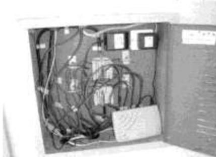
Caixa telefonia/rede - (antes)
