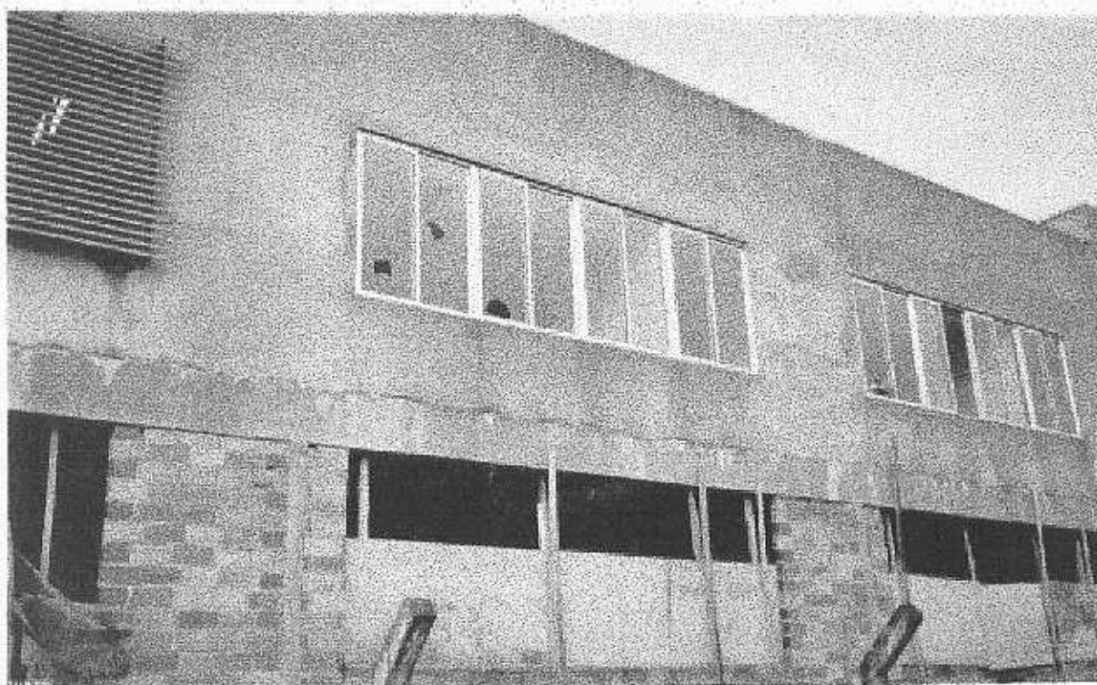
Bloco Salas de Aula - Reboco apenas próximo as janelas, sem pintura. - Vidros quebrados. A ausência de muro alto favorece a ação de vândalos.
