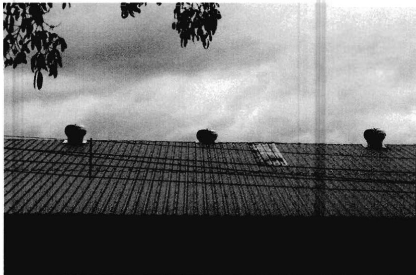
FIGURA 5: Exaustores instalados no G1.
